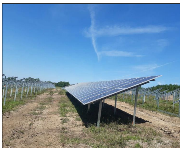
Figure 17 : Exemple de structures porteuses utilisées (Source : TECHNIQUE SOLAIRE)
